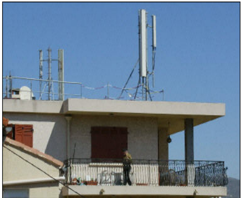
Gérard Julien AFP/Archives : Une antenne-relais de téléphonie mobile installée sur le toit d'un immeuble à Marseille
