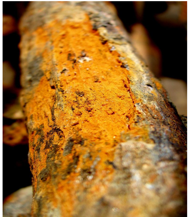
Conduite d'eau corrodée
