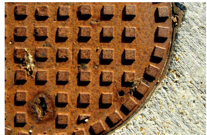
Effets significatifs corrosion
