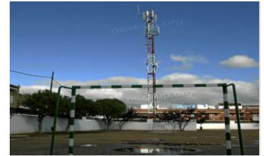
Mobilfunkbasisstation Manuel de Falla schule - Brenes.
