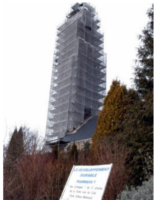
En travaux, la basilique de Sion sert de support à cinq antennes de téléphonie mobile. Photos Michel FRITSCH
