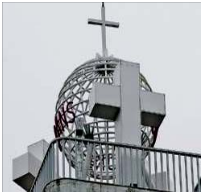
Next-up : detalle de las 3 antenas enlace de telefonía móvil del operador Vodafone que se camuflan en las 3 cruces del campanario de la iglesia de Fatima.
