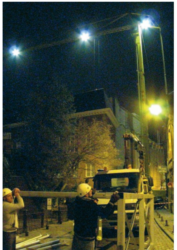
Le chantier s'est organisé à la hâte, en pleine nuit. Les riverains sont choqués. | J.Y.DAL
