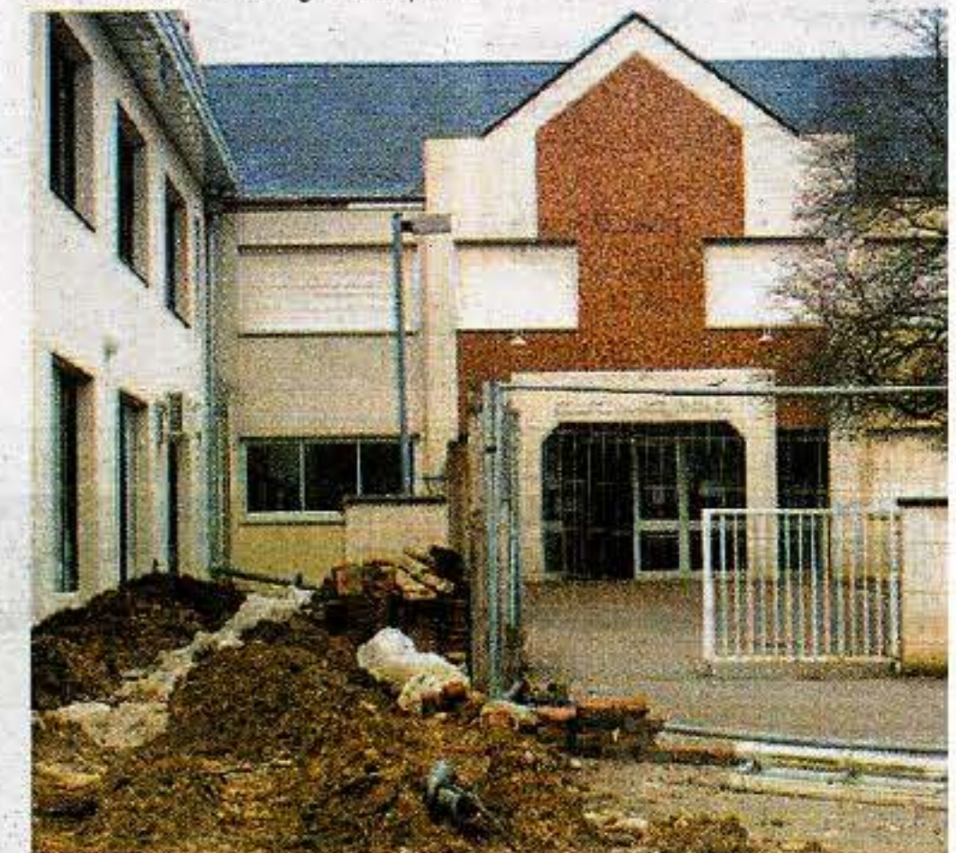
Le collège est en travaux depuis un an. Des travaux qui pourraient être la cause de la contamination.
