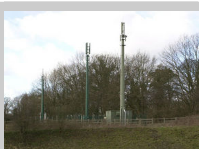
Il y a des milliers de pylônes en Grande-Bretagne
