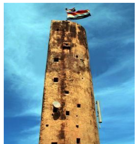
Antennes relais et Répéteurs Hertiens sur la tour du fort de Jaigarh à Jaipur Inde. (Next-up)
