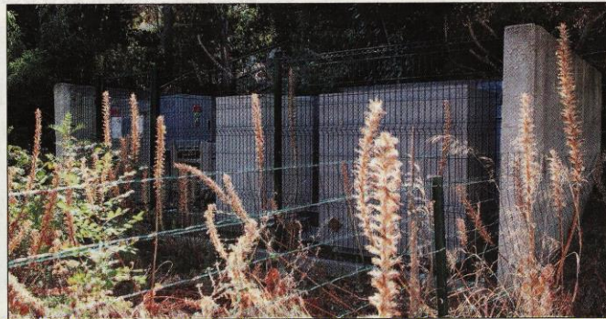
En plus des antennes, leur local technique est accolé à la propriété : peu esthétique, il est aussi bruyant.
