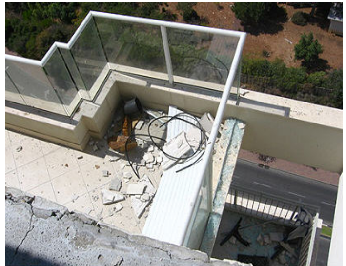
Les dommages causés suite à l'explosion
