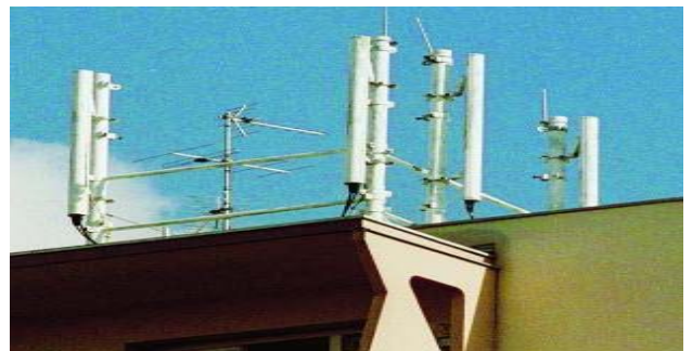
Ce sont des antennes de ce type qui devait être installées boulevard Mansart (photo archives BP-LD)
